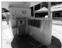
品川駅前、地下に設置された駐輪場「エコサイクル」
